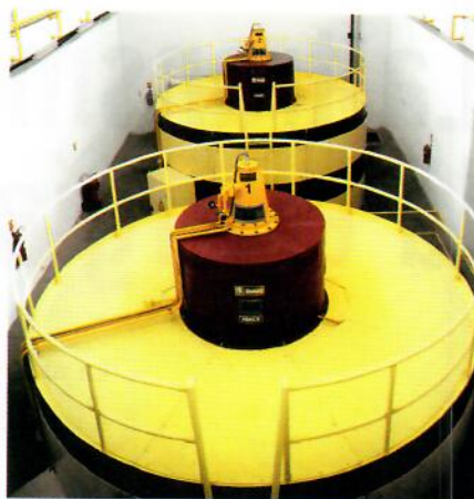
Alternador de una central hidroeléctrica
